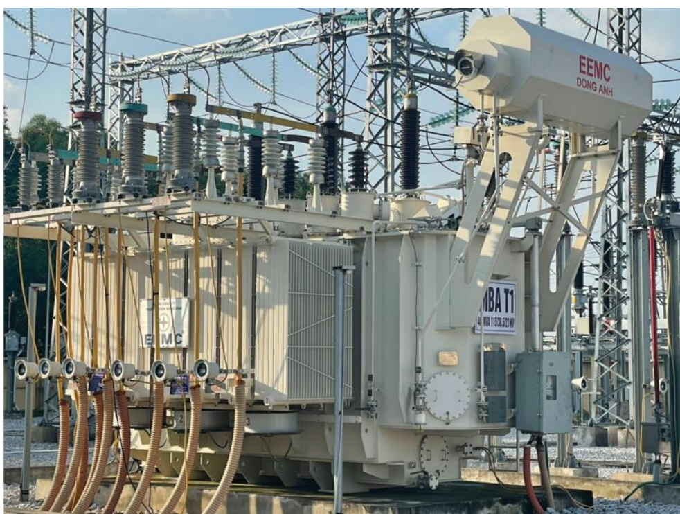
Hình 1.1. Trạm biến áp không người trực 110kV Tây Thanh Hóa
